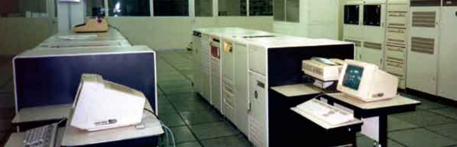
Centro Regional de Telecomunicações – Processo de modernização e automação do sistema de telecomunicações. Introdução de sistema gráfico para traçado automático de cartas meteorológicas e utilização de microcomputadores como as estações de trabalho dos meteorologistas.
