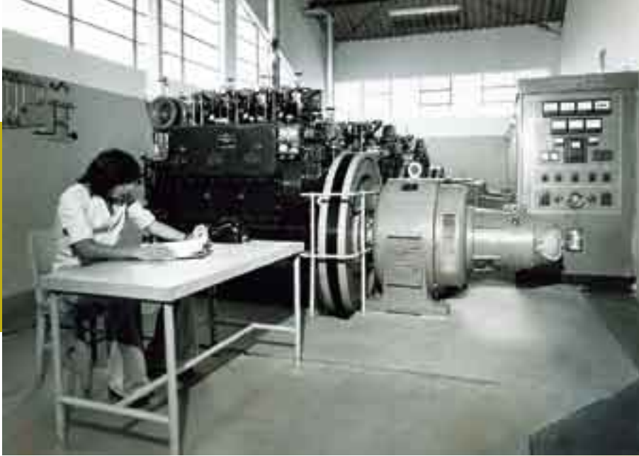
Funcionário junto ao gerador de energia, equipamento necessário para evitar a interrupção de envio e recepção de dados. Contagem (Região de Sobradinho - cidade satélite de Brasília), década de 1980. Foto: INMET
