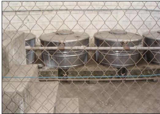
Figura 63: Tanques de lavagem.
