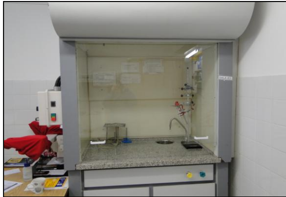
Figura 27: Capela de exaustão.
