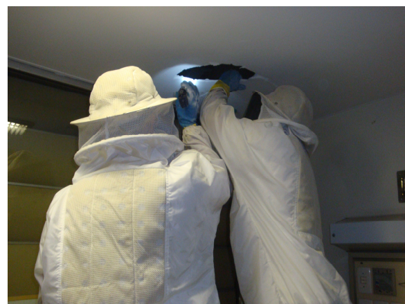
Figura 2. Etapa de remoção do ninho de abelha Partamona sp.
