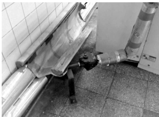
Figura 3. Tubería con aislante deteriorado
