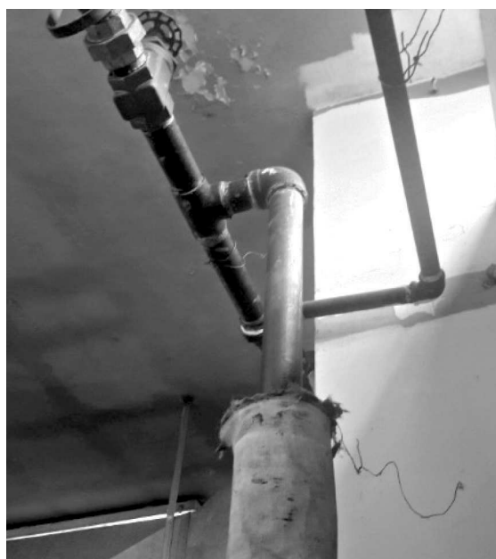
Figura 4. Tubería sin aislante
