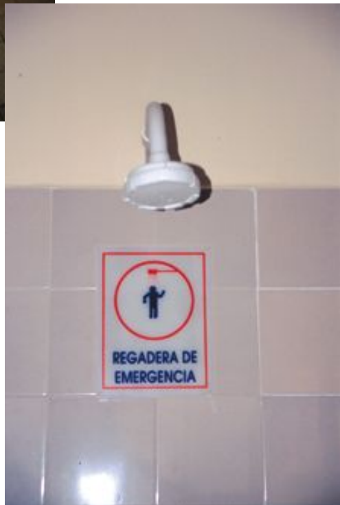
Regadera de seguridad que debe existir en todo establecimiento de salud
